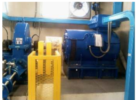
Centralina idroelettrica nell'acquedotto di Roncobello (BG) [18]
